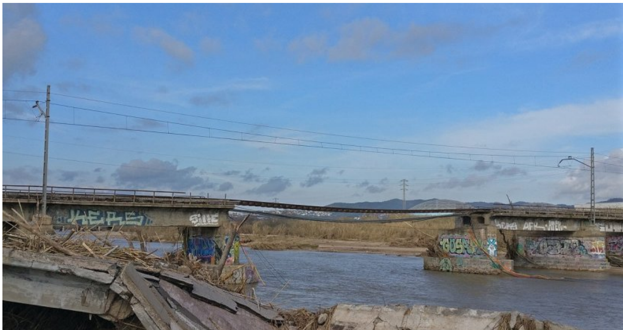
Destrucció dels ponts viari i ferroviari de la Tordera durant el temporal Gloria (gener 2020) © Viquipèdia
