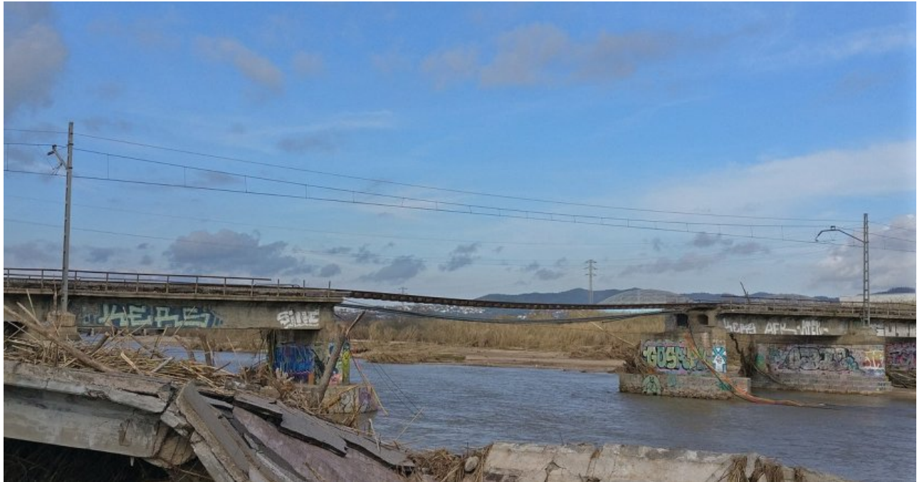
Destrucción de los puentes viario y ferroviario de la Tordera durante la borrasca Gloria (enero 2020) © Wikipedia
