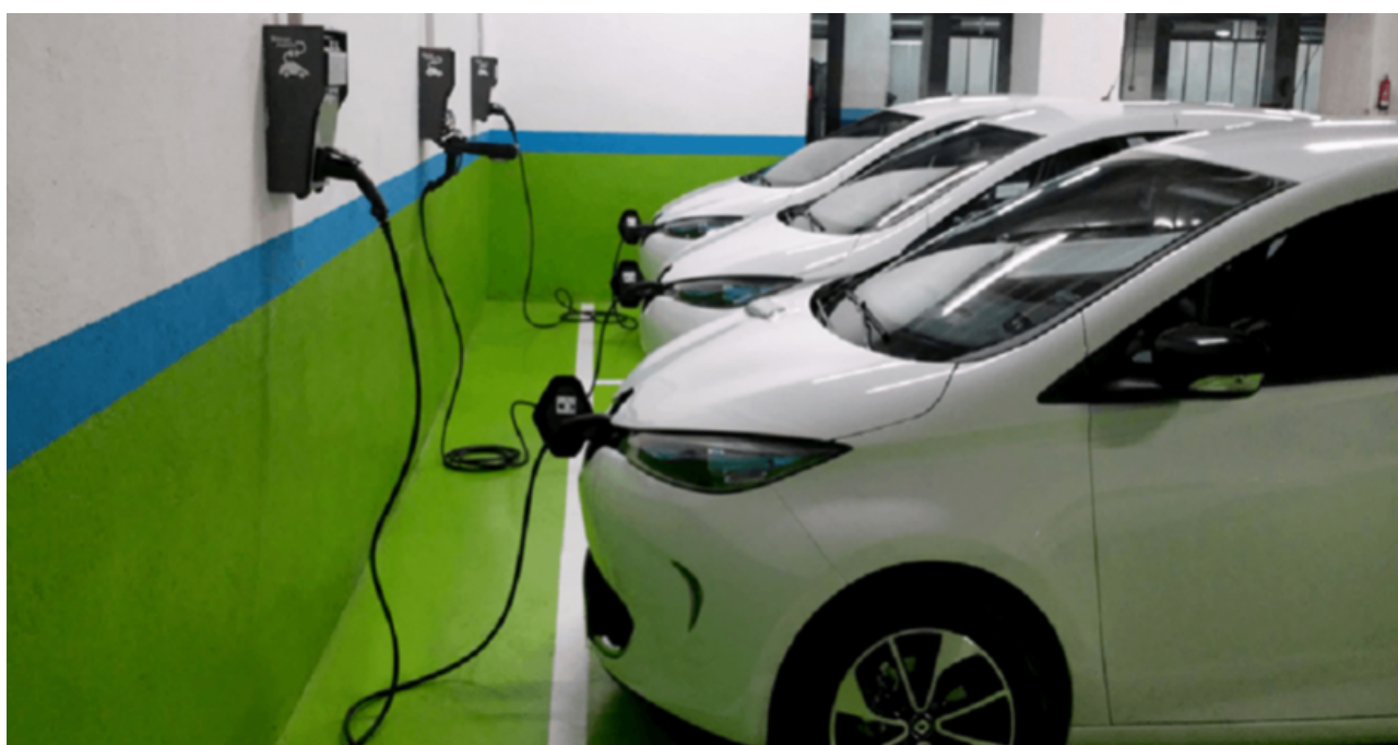
Carregadors de vehicles elèctrics en un pàrquing municipal © ERF
