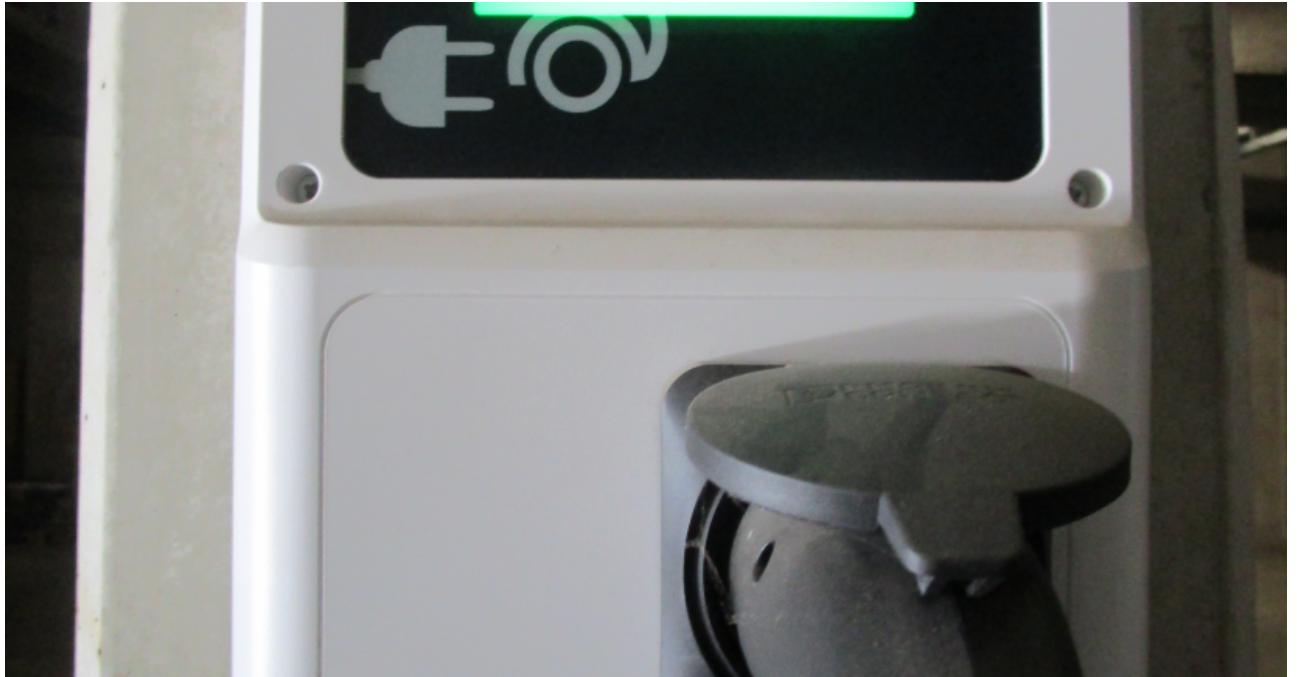
Cargador eléctrico en un pàrquing municipal de Barberà del Vallès © ERF
