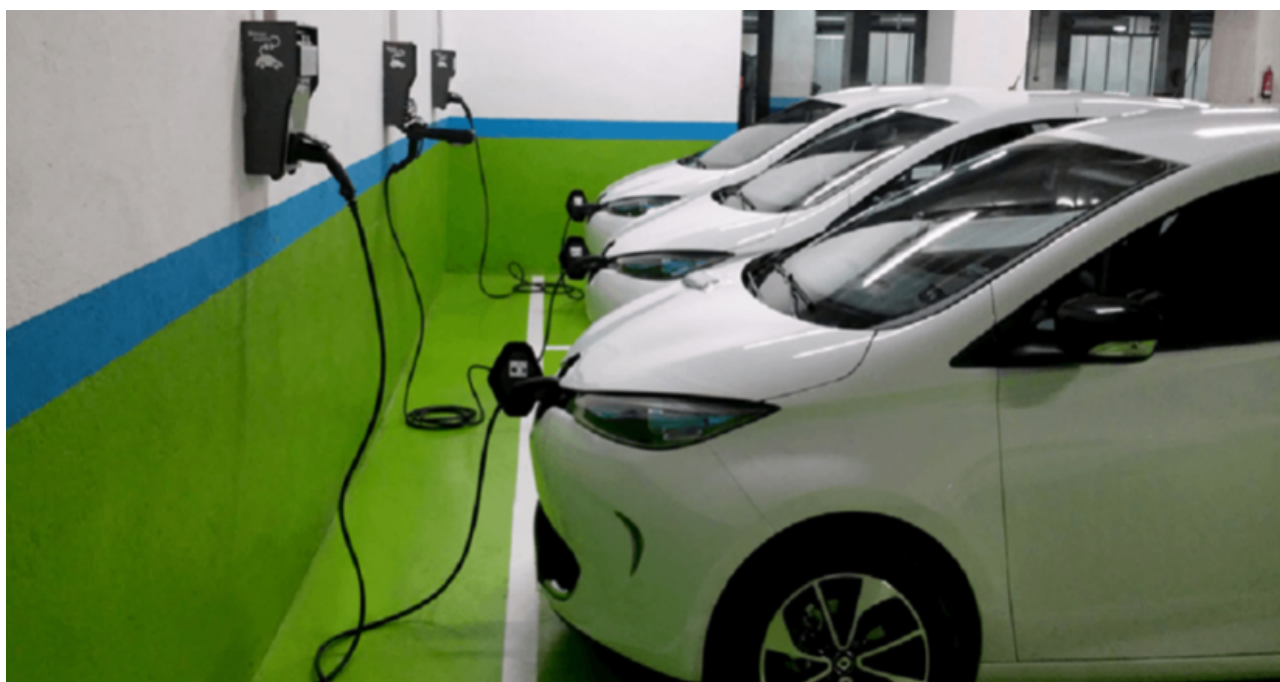
Carregadores de vehículos eléctricos en un párquing municipal © ERF
